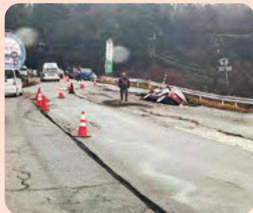
地割れによる道路陥没や隆起
