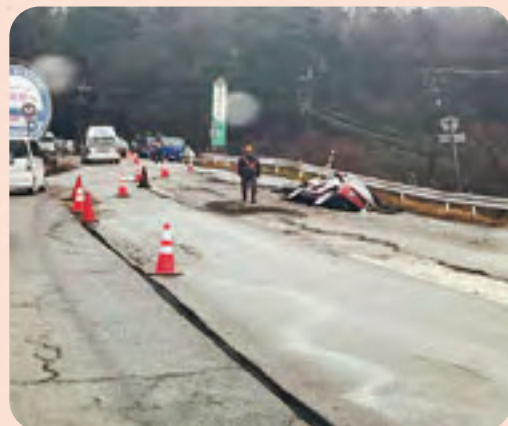
地割れによる道路陥没や隆起
